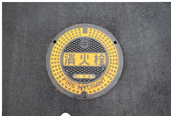
消火栓 町内に4ヶ所
